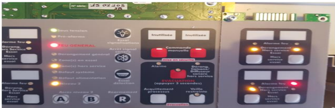
Lors de l'enclenchement du DM nous avons pu apercevoir qu'il s'allume en rouge et qu'il fait remonter un message à la centrale. Nous pouvons voir qu'il y a le voyant 'FEU GENERAL' d'allumé et le voyant 'Alarme feu' sur notre carte d'extension qui correspondait à notre ligne de Dm
